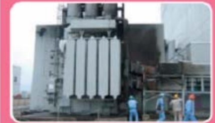
3号機所内変圧器の火災
