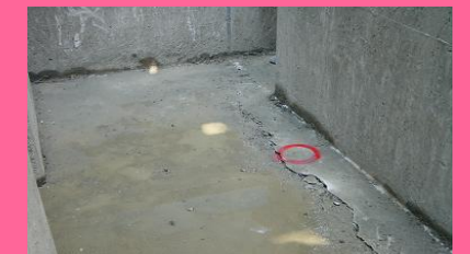
変圧器防油堤内のひび割れ
