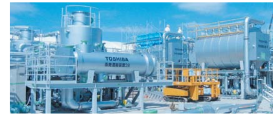
塩分除去用蒸発濃縮装置
