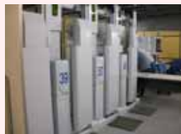
ゲートモニタ設置状況
