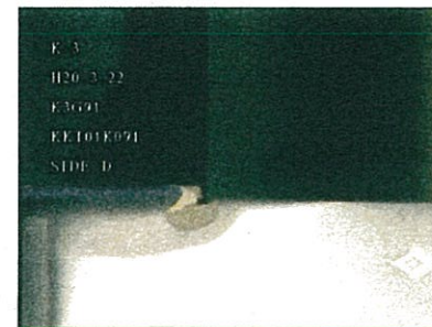
K3 剥離状況 (KKT01K091)
