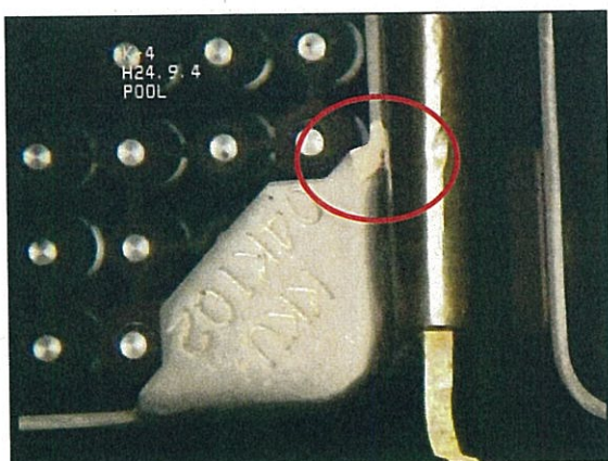
図2 4号機の使用済燃料プールで確認されたクリップ接合部の状況
