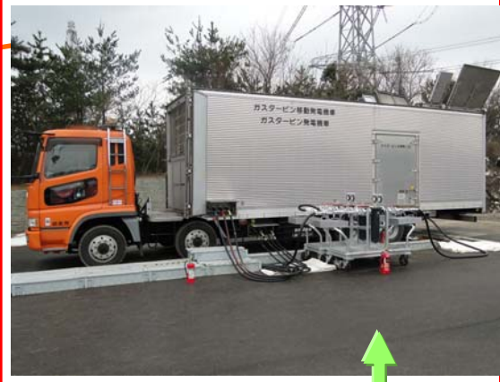
空冷式ガスタービン発電機高台配備
