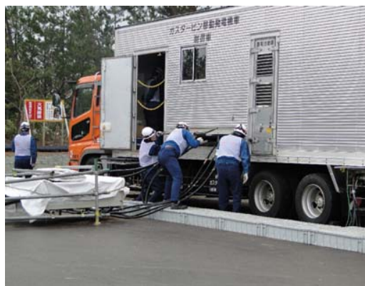
GTGによる電源供給訓練風景
