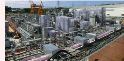
ALPS設置エリアの全景
