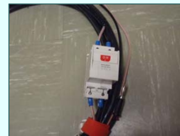
仮設操作スイッチ と仮設ケーブル
