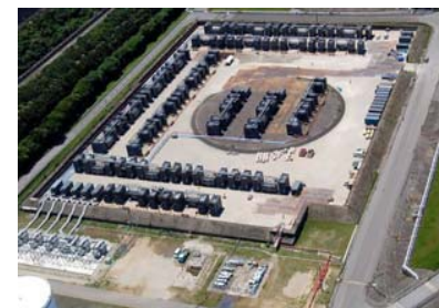
袖ヶ浦火力発電所 (GE102台)
