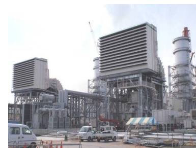
鹿島火力発電所 (GT3台)
