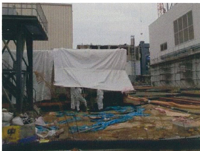
(当該配電盤の外観：カバーが掛けられている。)
