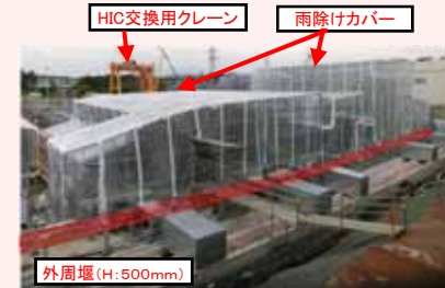
ALPS設置エリアの全景（2012/11/17）
