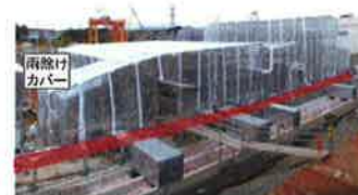
放射性物質(トリチウムを除く62核種)を除去する多核種除去設備の設置
