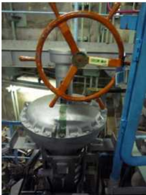
主蒸気逃がし弁の手動操作ハンドル
