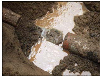
埋設消火配管の損傷
