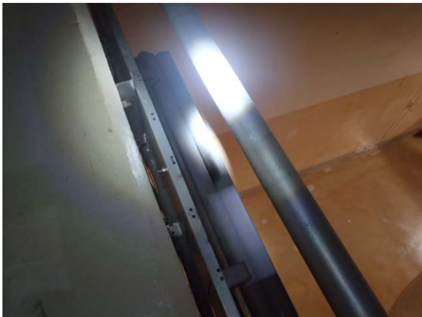
蛍光灯を上部から見た写真
