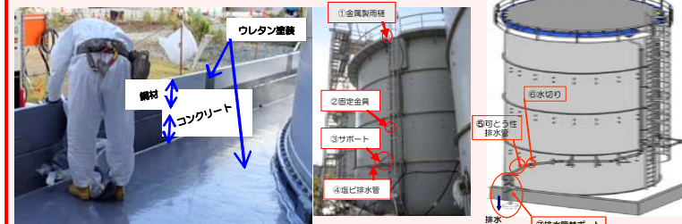
鋼材による堰の嵩上げ タンクへの雨どいの設置 対策実施状況
