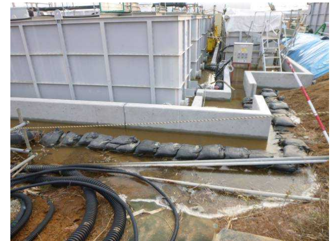
漏えいの状況 (③エリア)
