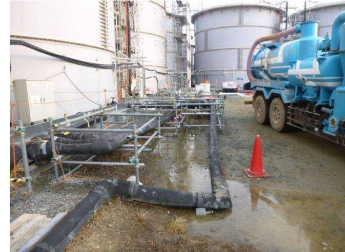
漏えいの状況 (①エリア)
