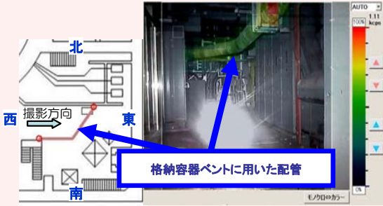
格納容器ベントに用いた配管周辺のガンマカメラ撮影データ
