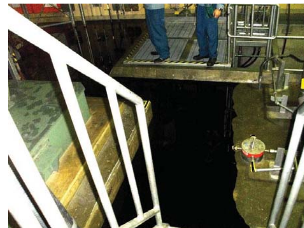
地下1階非常用ディーゼル発電機B号機室における油の漏えい状況
