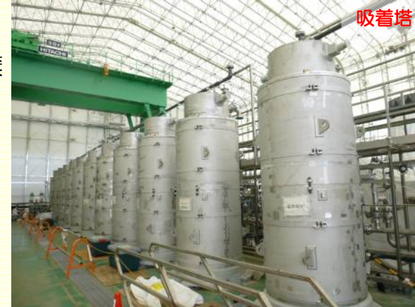
<高性能多核種除去設備 設置状況>
