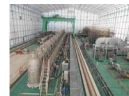
(高性能多核種除去設備の設置状況)
