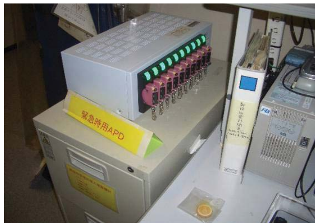
中央制御室へのAPDの新規配備 (1-5号機：10台、6-7号機：20台)
