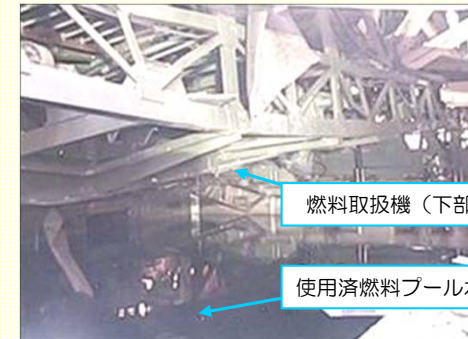
<1号機使用済燃料プール上部のガレキの状況>
