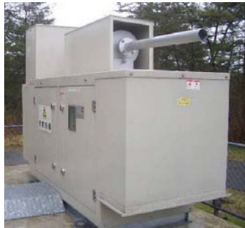
モニタリングポスト電源 バックアップ用発電機 (MP 3箇所につき1台)
