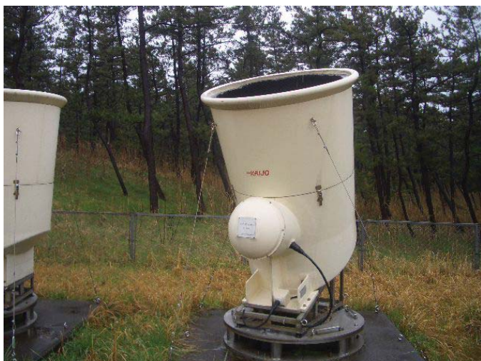
常設気象観測設備
