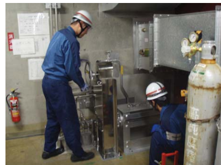
ベント弁の遠隔操作設備を操作している様子
