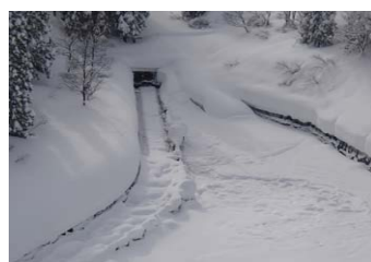
写真-4:導水路出口への氷雪堆積
