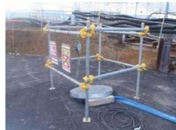
是正後（開口部にバリケードを設置）
