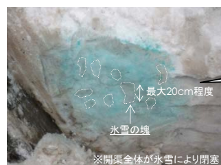
写真-5:導水路出口 開渠の氷雪
