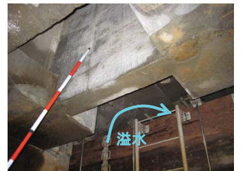
写真-2:溢水箇所での水位上昇(26号横坑)
