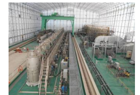
(高性能多核種除去設備の設置状況)
