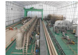
(高性能多核種除去設備)
