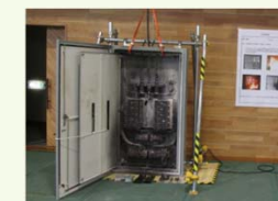
作業中の短絡により発火・延焼した実際の分電盤の展示（短絡の怖さを知る）
