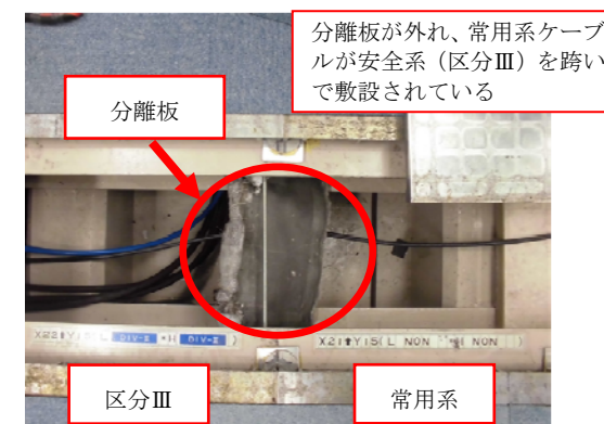
中央制御室床下 6号機 分離板・ケーブル敷設状況
