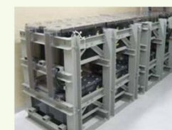
直流125V蓄電池等を追設し、従前の3倍以上（24時間以上）の直流電源容量を確保
