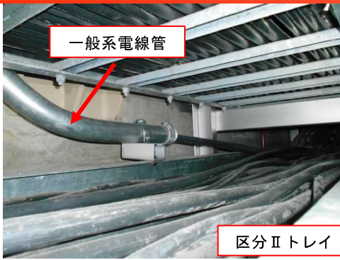
3号機 ケーブル敷設の不適合パターン例 (現場ケーブルトレイ)
