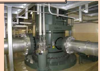
残留熱除去系ポンプ
