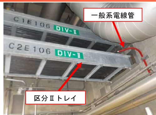
7号機 ケーブル敷設の不適合パターン例 (現場ケーブルトレイ)
