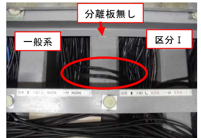
3号機 分離板が設置されていないため通過している
