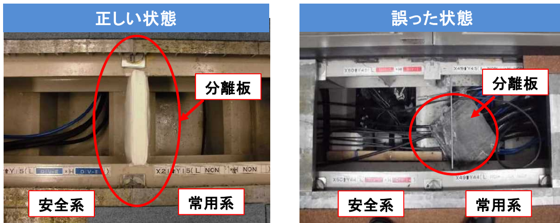
ケーブルの正誤状態
