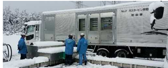
積雪時におけるGTG運転訓練
