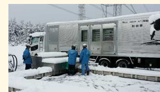
積雪環境でのガスタービン発電機車の運転訓練
