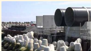
港湾内へ付替えたK排水路の排出口
