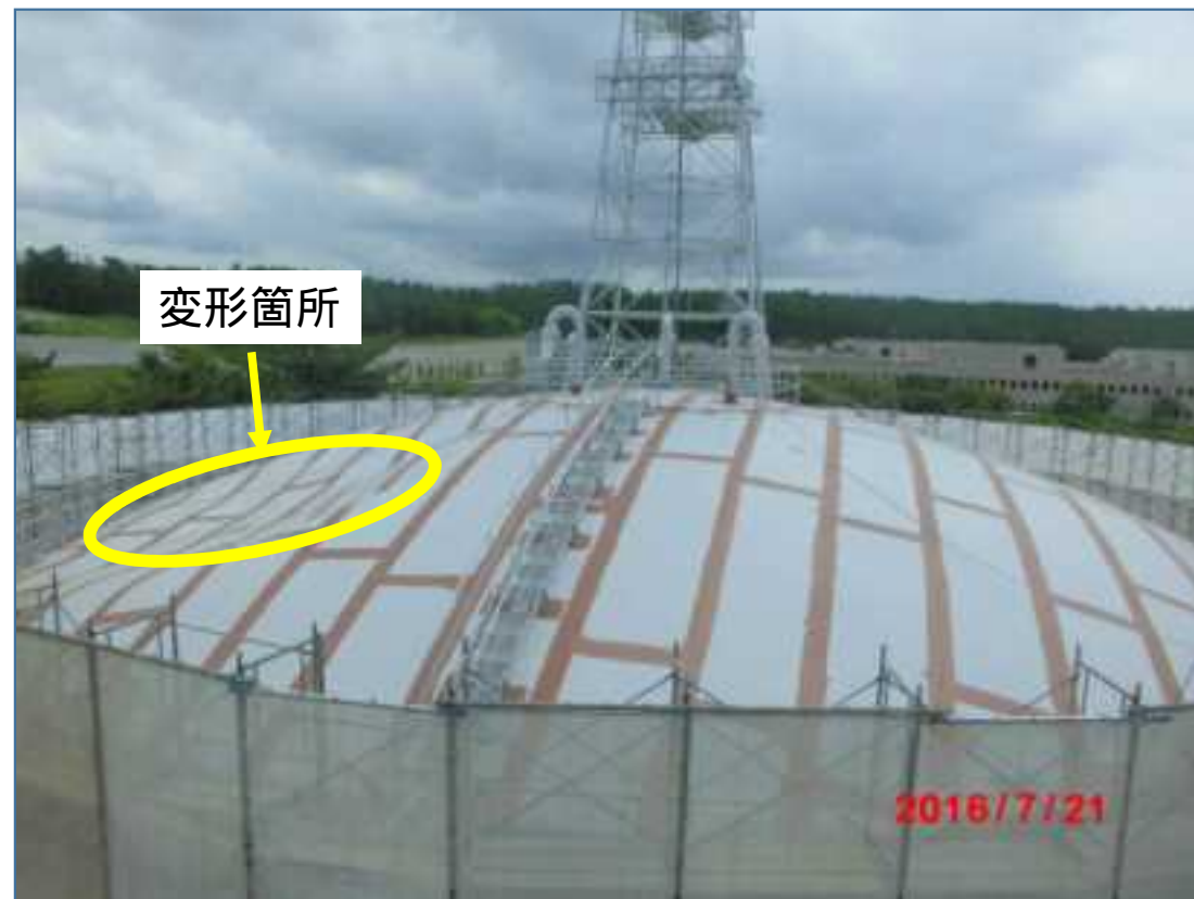
ろ過水タンク変形箇所
