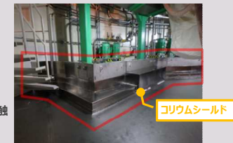
過酷事故発生時に溶融燃料と原子炉格納容器が接触することを防止するコリウムシールドを設置【7号機】
