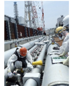
(凍結管バルブ開閉操作の様子)
