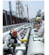
(凍結管バルブ開閉操作の様子)
