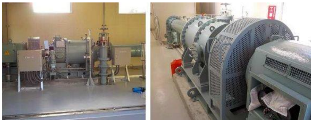
小水力発電機(出典:柏崎ガス水道局)
