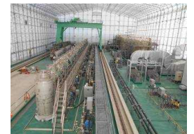
(高性能多核種除去設備)
