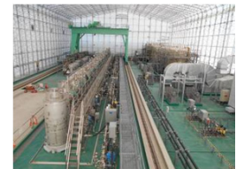
(高性能多核種除去設備)
