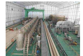
(高性能多核種除去設備)
