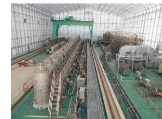
(高性能多核種除去設備)
