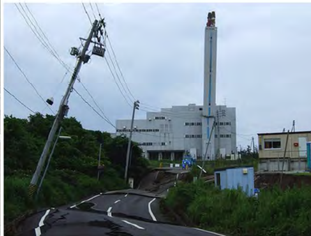
第 11-11-31 図 河道沿いの道路被害 （土木学会（2010））
