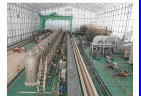
(高性能多核種除去設備)
