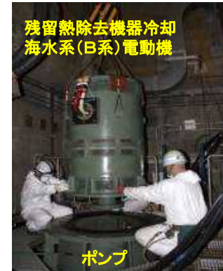
残留熱除去機器冷却海水系(B系)電動機 電動機の据付作業
