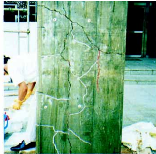
アルカリ骨材反応による 柱のコンクリートひび割れ例
