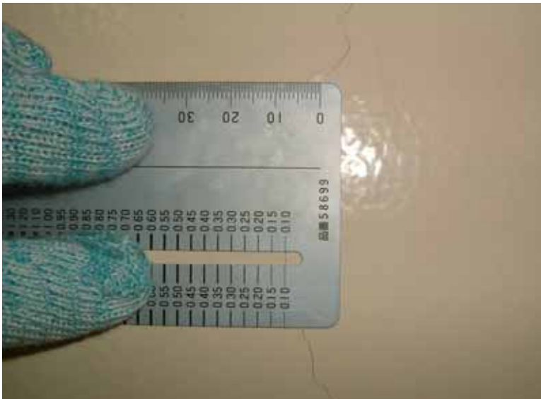
4号機原子炉建屋地下5階(最地下階) 外周部壁のひび割れ
