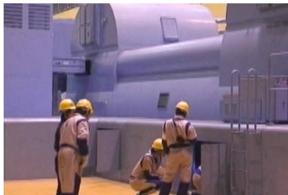
発電機の確認
