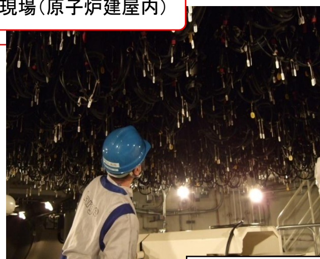
制御棒の作動状況の確認
