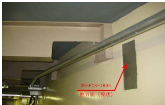
誤って撤去されたサポートの跡
