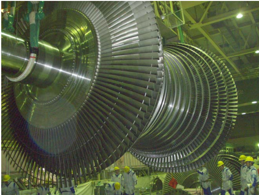
(写真) 福島第一5号機高効率化タービン：08年
