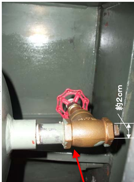
閉止栓 (漏えい箇所)
