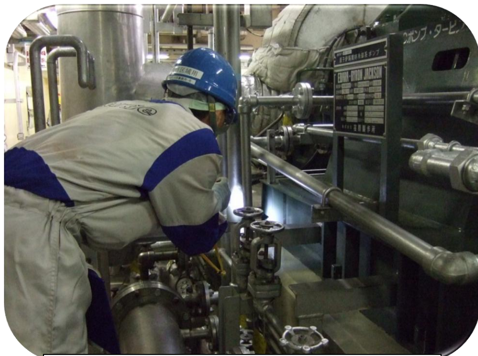
原子炉隔離時冷却系ポンプの運転状態確認
