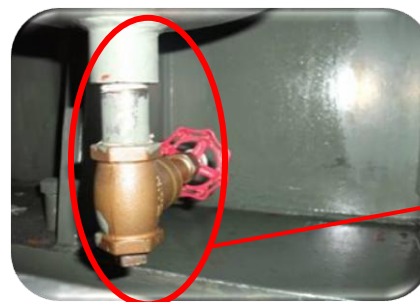
漏えい箇所 (直径約2cm)
