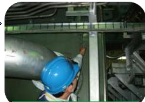
油フィルタドレン弁閉止栓の確認
