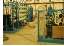
IV. 淡水化装置 (逆浸透膜(RO)方式)
