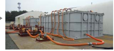
V. 処理水受けタンク
