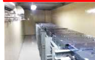
所内常設直流電源設備 (3系統目)
