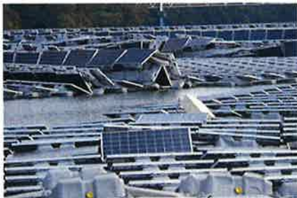
＜台風による水上型太陽光パネルの破損の様子＞
