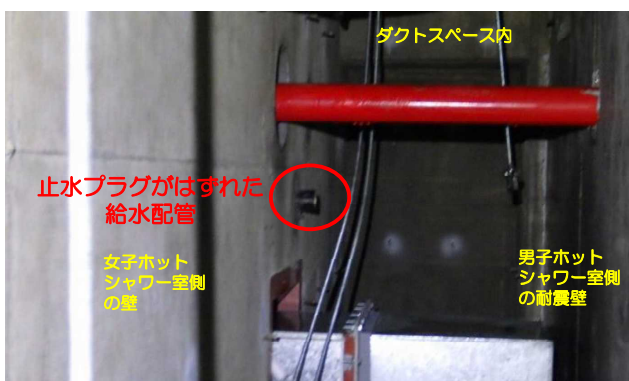
【漏水箇所写真】
