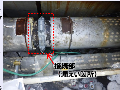
<保温材取り外し後の接続部漏えい箇所>
