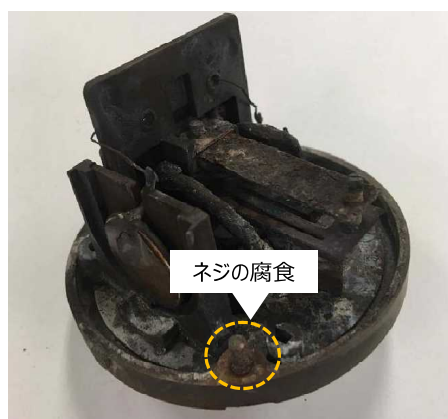
当該自動点滅器センサー部 内部
