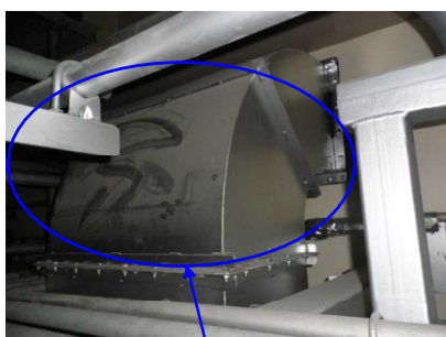
a. 7号機原子炉建屋 空調ダクト
