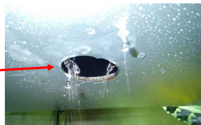
<循環水系配管欠損箇所（拡大図）>
